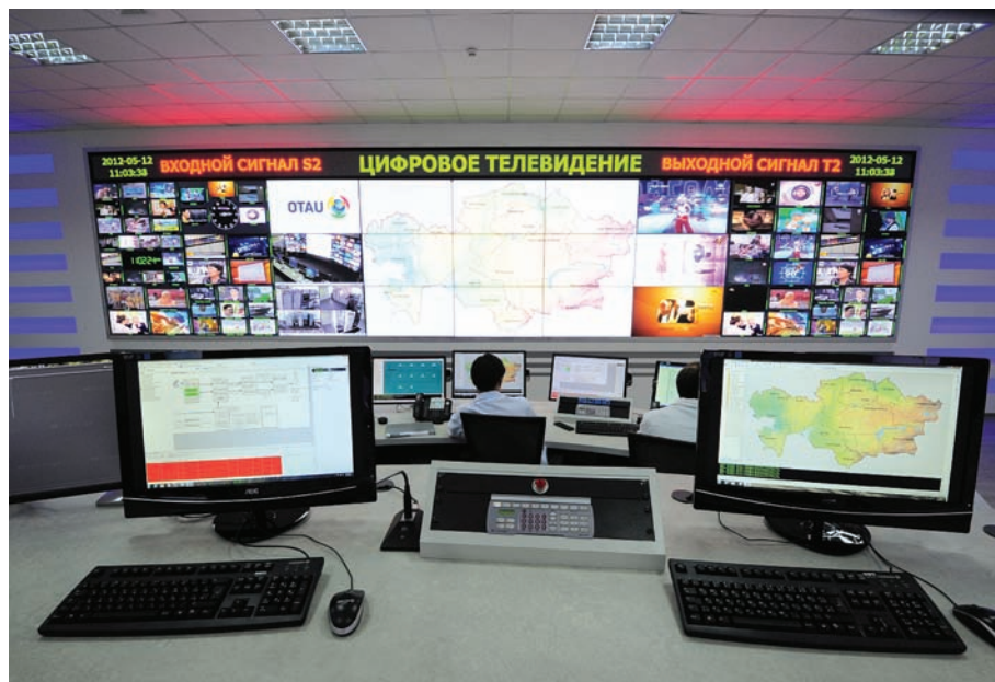
Главный центр мониторинга и управления национальной сетью телевидения.
