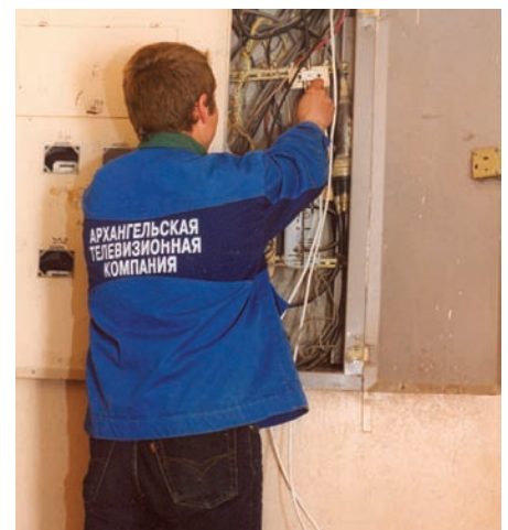
Монтажник «Архангельской телевизионной компании» работает с распределительным оборудованием сети на лестничной площадке. Май 2002 года.
