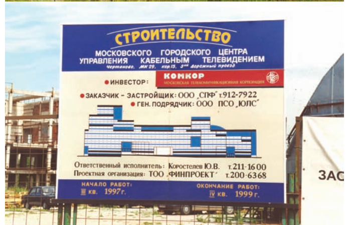
Строительство здания и телепорта московской кабельной сети «Комкор», июнь 2000 года. Сейчас эта сеть носит название «Акадо».
